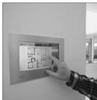
An der Energyday-Ausstellung wird unter anderem gezeigt, wie mit moderner Gebäudetechnik Energie gespart werden kann. FOTO: ZVG
